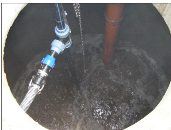
Abwassergrube mit Pumpeinheit ausgerüstet
