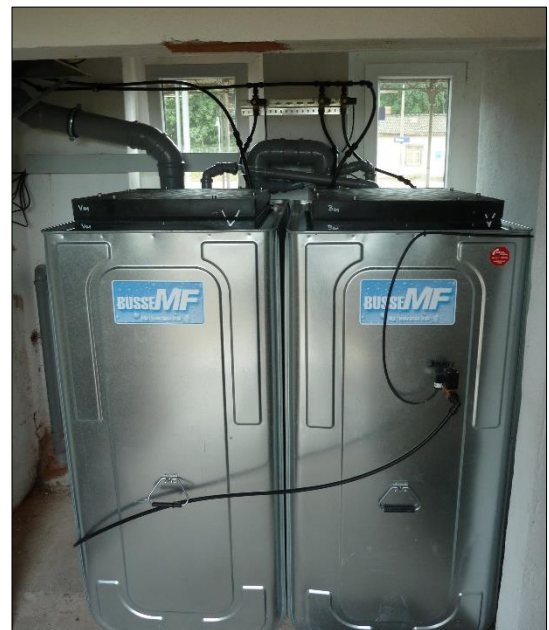
Die Membrankläranlage BUSSE-MF im Erdgeschoss des Stellwerks.
