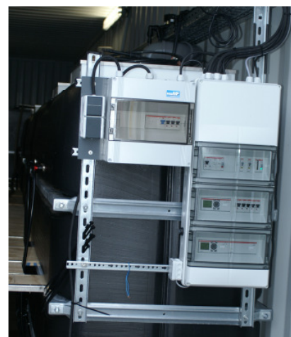
Steuerungseinheit der Abwasser-Recyclinganlage BUSSE-MF
